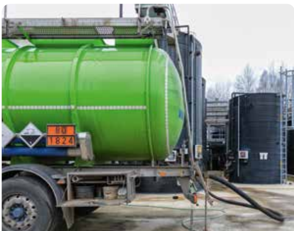
Anlieferung von Natriumhydroxidlösung in der WBA Schlema-A.
