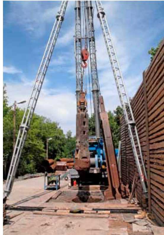
Bohrarbeiten am Wetterbohrloch WISMUT-Stolln Freital, ausgefahrener Fallmeißel (rechts) und Greifer zum Heben des Bohrgutes im Einsatz, Juli 2008 (Bild 5.1-6)
