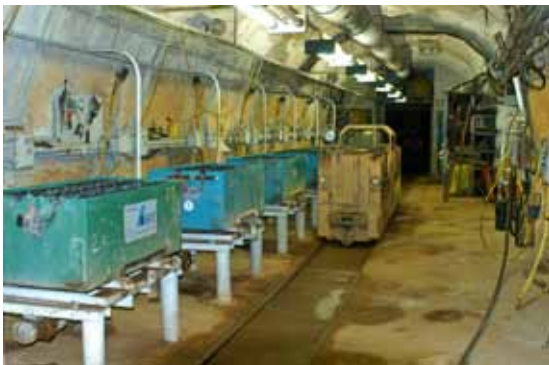
Batterieladestation auf der 135-m-Sohle im Grubenfeld Süd unter Tage (Bild 4.1-3)
