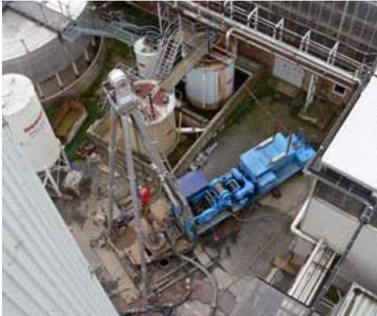
Bohrmaschine zur Herstellung des Förderbohrlochs B auf dem Gelände der AAF, September 2008 (Bild 4.1-2)
