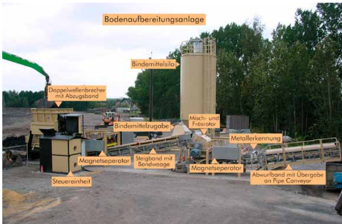
Neue Bodenaufbereitungsanlage (Bild 7.1-1)
