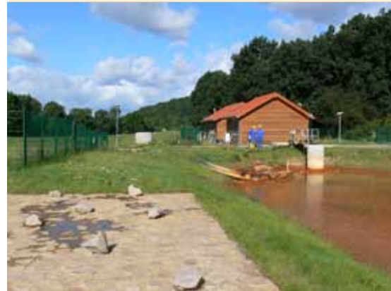
Pumpenstation und Speicherbecken im Gessental, August 2008 (Bild 6.1-3)
