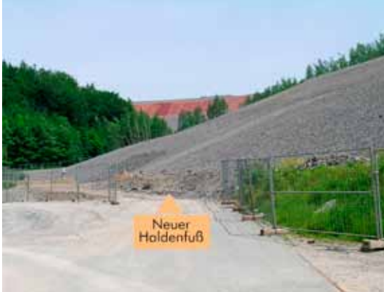
Profilierung Böschung unterhalb der Haldenstraße auf dem Areal des ehemaligen Feuerlöschteiches, Mai 2008 (Bild 2.1-5)
