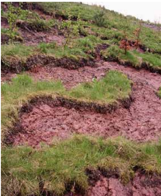
Detailaufnahme der Rutschung an der Halde 366, April 2008 (Bild 2.1-10)
