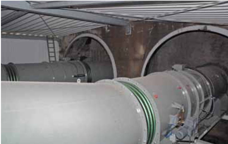
Neu eingebaute Lüfteranlage am Schacht 382, Dezember 2008 (Bild 2.1-1)
