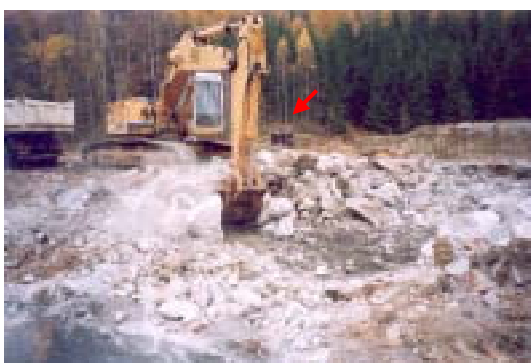
Bild 2.3-3 Abbruch Fundamente auf der Betriebsfläche Schacht 387, im Hintergrund sichtbar Anhänger mit Meßeinrichtungen zur Überwachung des Luftpfades
