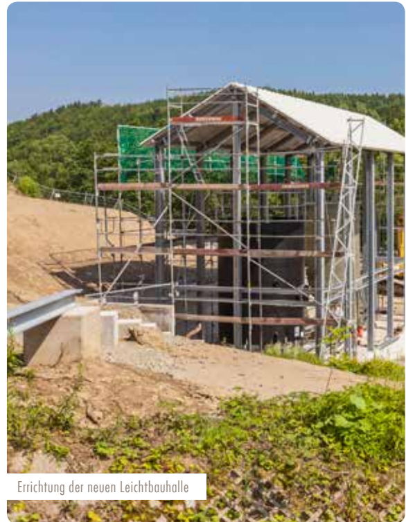
Konventionelle WBA im Umbau
