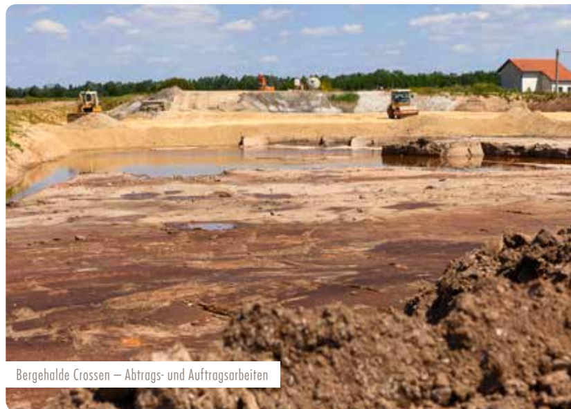
Überflutete Sanierungsfläche Anfang Juni nach Starkniederschlägen
