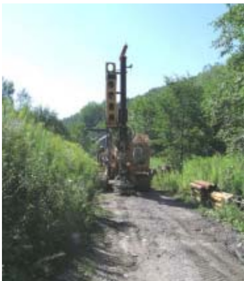
Bild 4.2.1-4 Bobrung einer Grundwassermessstelle im Bereich Talane Zwickauer Mulde zur Überwachung der finalen Flutung am Standort Schlema-Alberoda, August 2004
