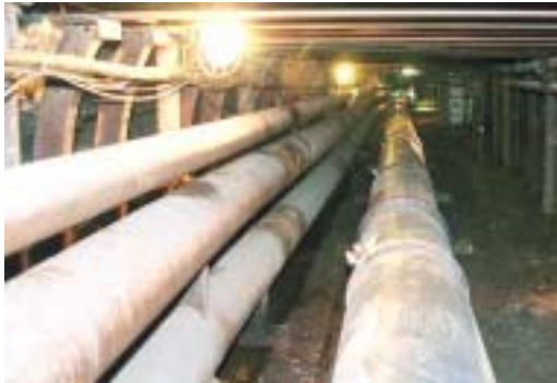
Bild 2.1-1 neue (in der Mitte) und alte (links) Flutungswasserleitung auf der -60-m-Sohle, Juli 2004
