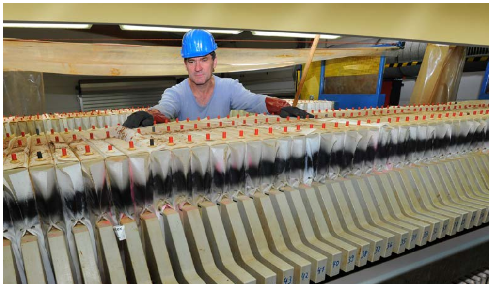
Kammerfilterpresse in einer Wasserbehandlungsanlage
