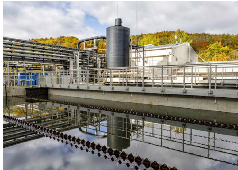
Klärungsbecken in der Wasserbehandlungsanlage Schlema-Alberoda (2021)
