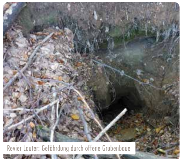
Revier Lauter: Einsenkung im Bereich eines tagesnahen Grubenbaues
