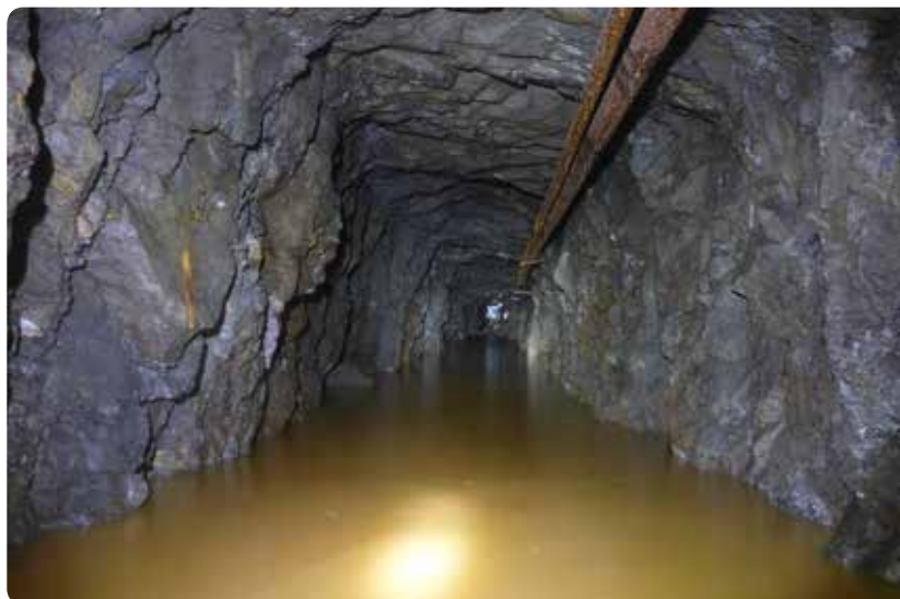
↑ Standwasser im Stolln 1 des Grubenfeldes 98, Breitenbrunn
