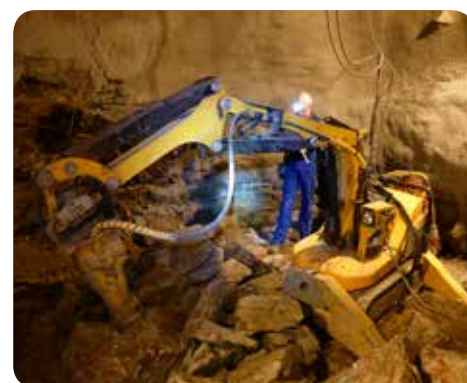
Tagesbruch Dörfler Weg, Annaberg-Buchholz
