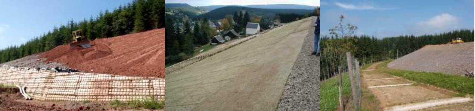
Zentralschachthalde Johanngeorgenstadt: Ostböschung - Einbau der Bewehrten Erde, Ostböschung - Fertige Abdeckung, Westplateau - Arbeiten zur Konturierung
