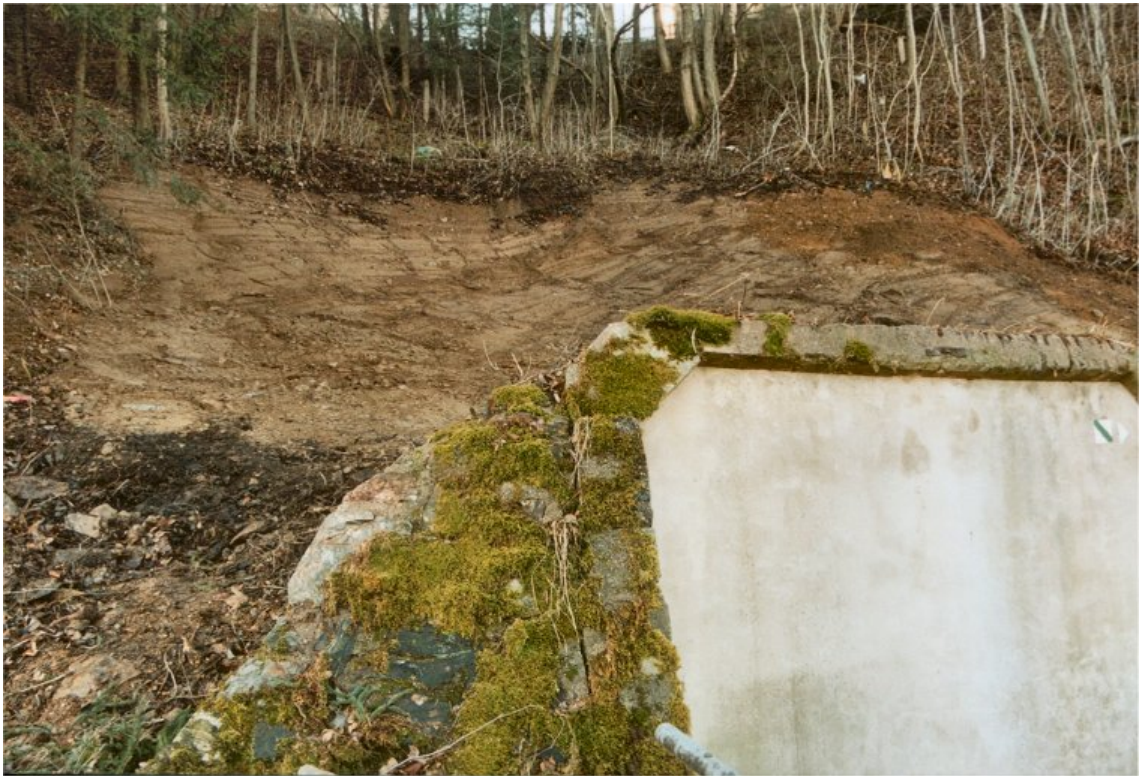
Verwahrter Tagesbruch am Querschlag 4 im November 2003
